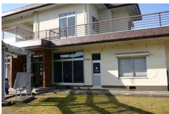
野島断層が横切った民家
