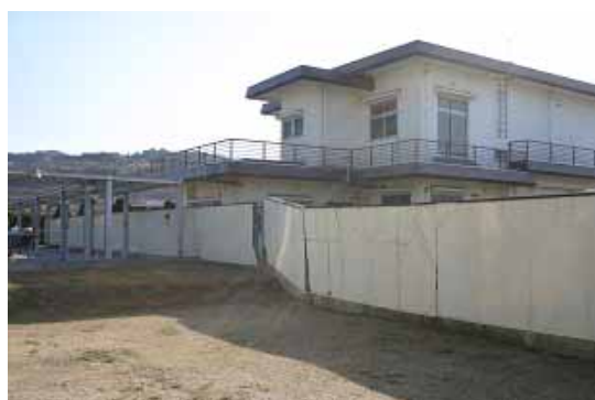
大きく横ずれしたブロック塀
