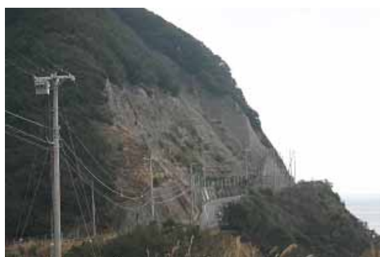
ロックネットが張り巡らされた県道 76 号
