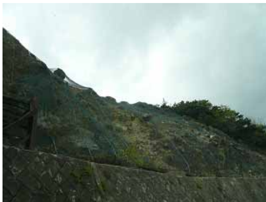
落石危険箇所が多い
