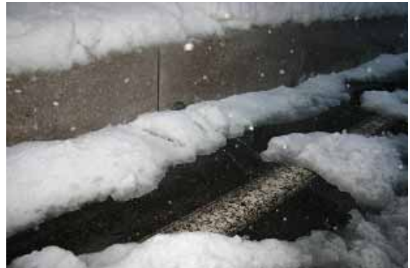
橋の地覆には消雪ノズルが取り付けられてお、散水が行われていた
