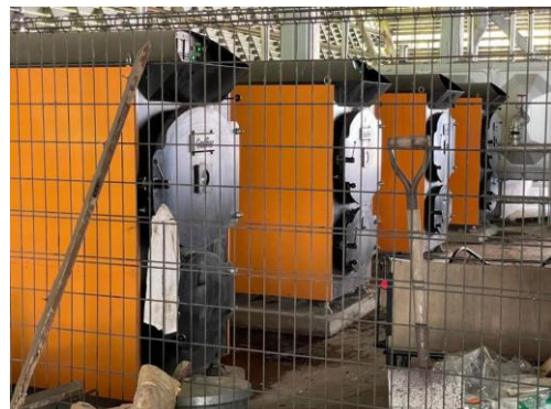
温泉の湯は、4基のボイラーで沸かしている
