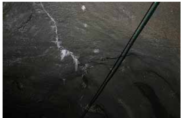
トンネルの天井には遊離石灰の「つらら」がた
