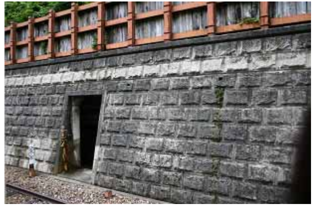
冬期歩道の出入り口。鉄道が運休する冬期の間も発電所員は休むことができない。このため、冬期でも作業員が通行できるように軌道に沿って、冬期歩道と呼ばれるコンクリートの人道トンネルが作られている。
