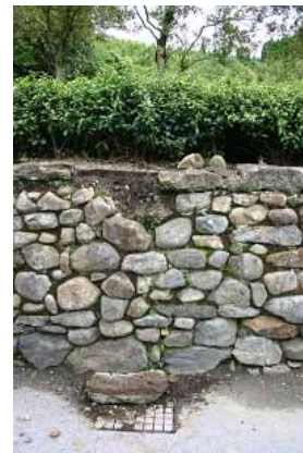
石垣からの抜け落ち
