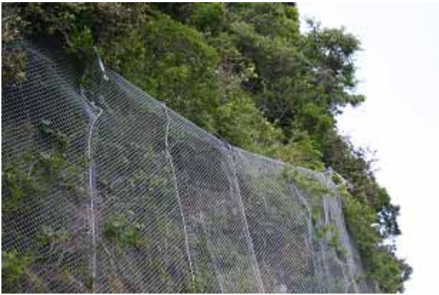
ポケット式ロックネットの吊りロープが破断
