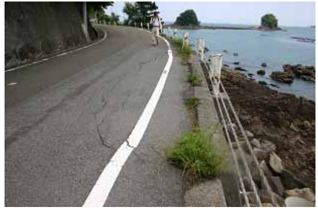
擁壁の頭部が海側へ傾き，路面が陥没している。
