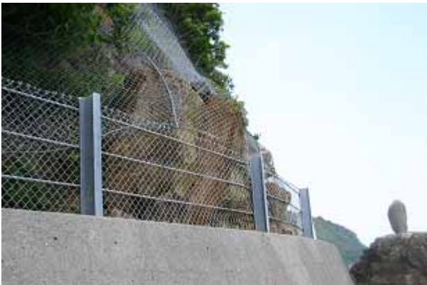
受け止めた落石がポケット式ロックネットの裾から転げ落ちるのをストンガードが支えている。
