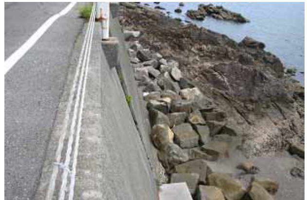
擁壁が傾斜したのは，根入れ部が洗掘され，支持力が低下したためと推察される。根固めが必要。
