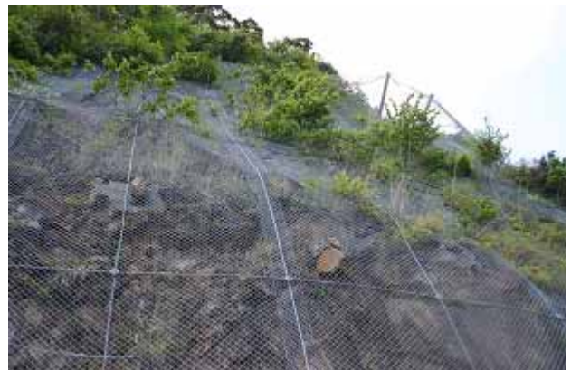
落石を受け止めているポケット式ロックネット
