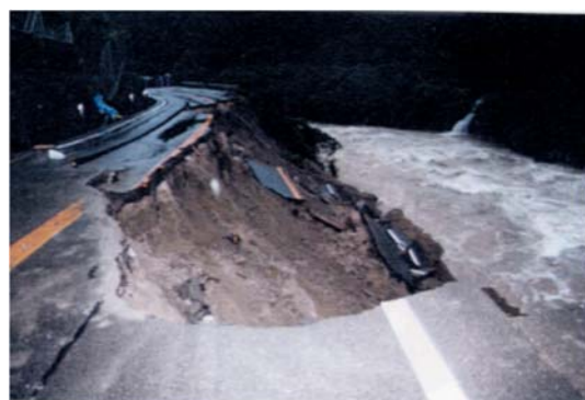
川側擁壁の倒壊
