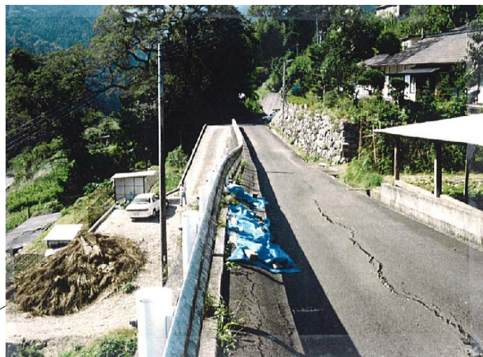
高知98豪雨(1998年9月)による災害 町道下桃原線(高知県大豊町桃原)
