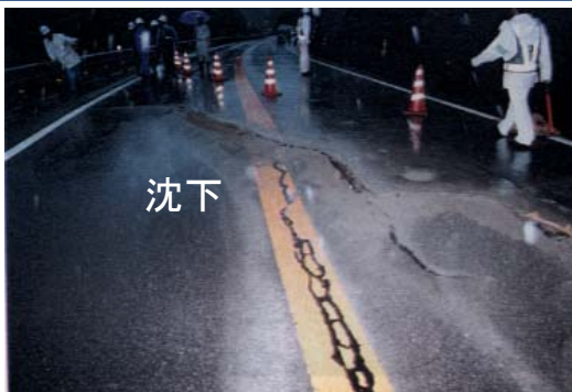
路面の亀裂と沈下
