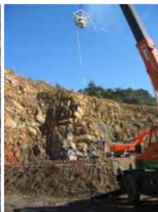
盛土厚1.8mへの落下
