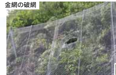
吊りロープの破断、支柱の破損
