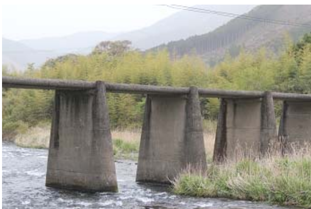
昭和40年に架設された清水大橋。橋長102.1m。幅員2.8m。一斗俵橋の約700m下流に架かっている。
