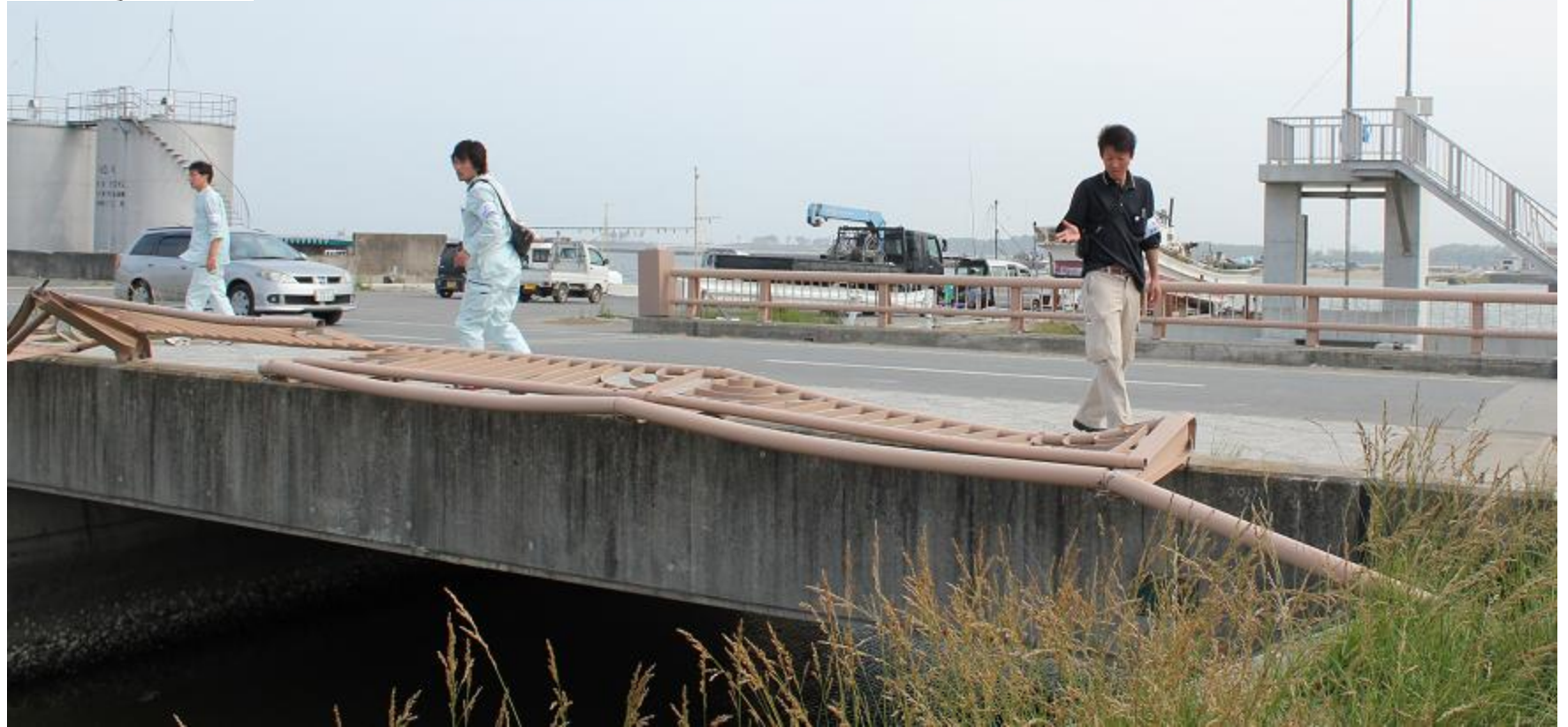
亶理町荒浜。船舶によって押し倒された橋の高欄
