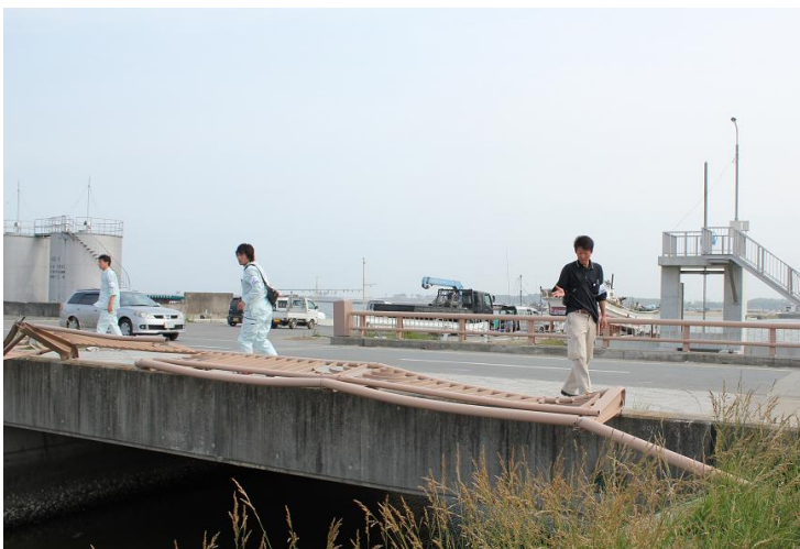
船舶が上流側の高欄を押し倒す
