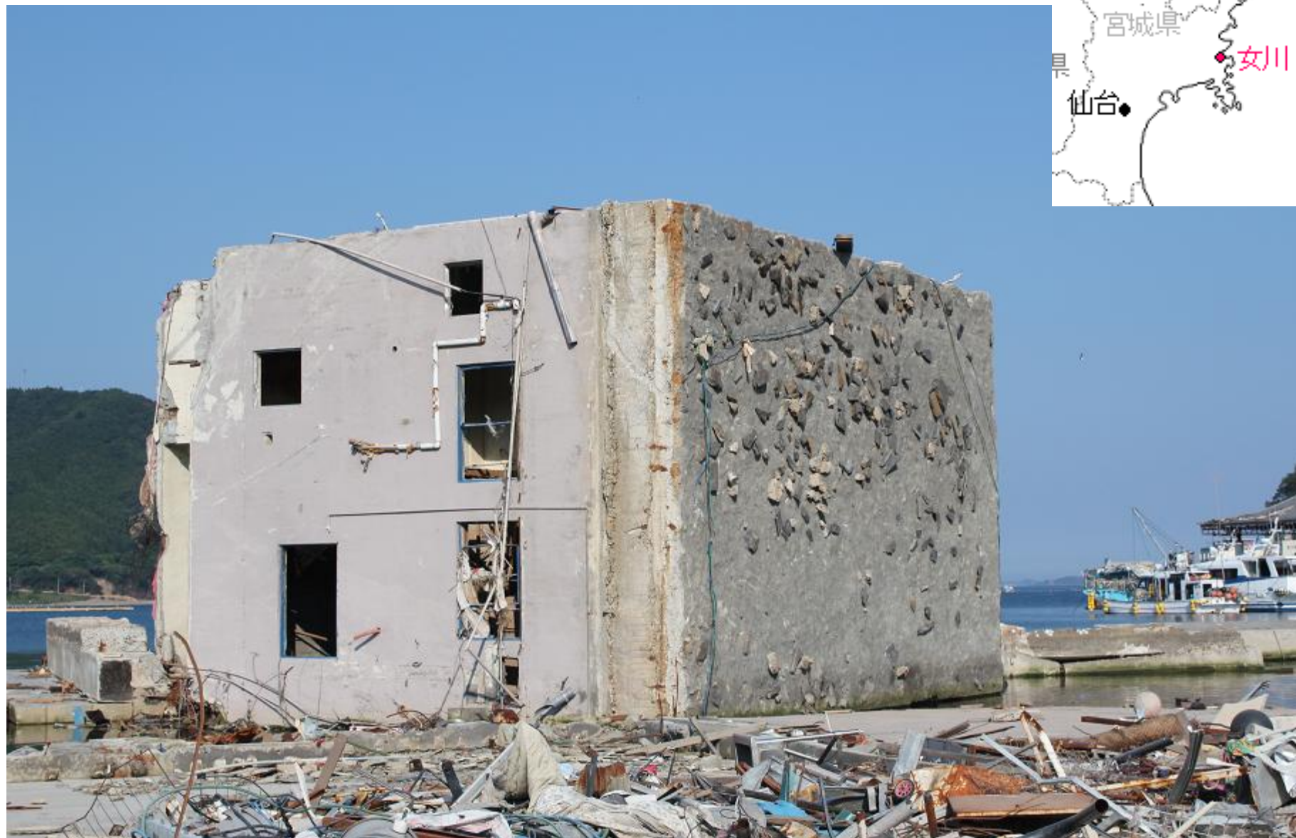
転倒したRC造のビル
