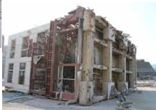
直径40cm、長さ5mのコンクリートパイル16本を打設していた4階建のビルが津波で転倒
