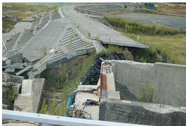
気仙沼市の津谷川を国道 45 号が横断する箇所に架けられていた小泉大橋も上部工が津波で流失している。
