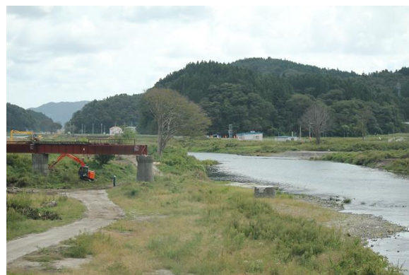
津波で流失した大船渡線の鉄道橋
