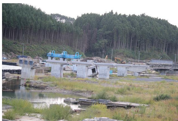
一般国道 45 号の歌津大橋は、伊里前湾に架けられた橋長 304m、12 径間の PC 桁橋。PC 桁は津波で流された。
