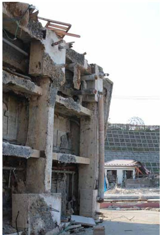
コンクリートパイルの破損状況
