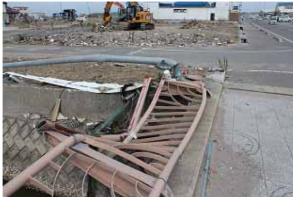
倒された高欄。船舶の船底のペンキが付いている。
