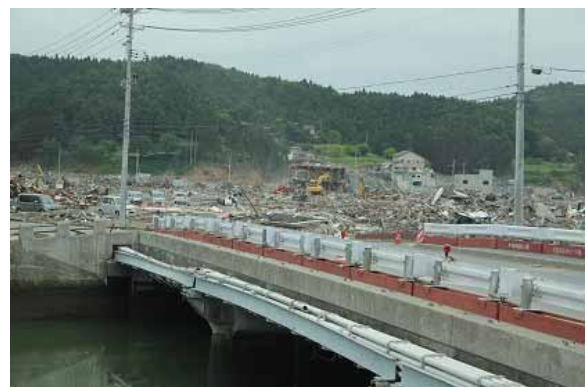
高欄は壊されても橋梁の損傷は軽微
