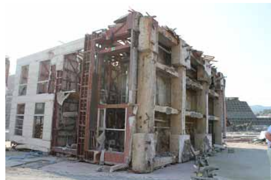
16本のコンクリートパイル打設されていたビルも倒壊
