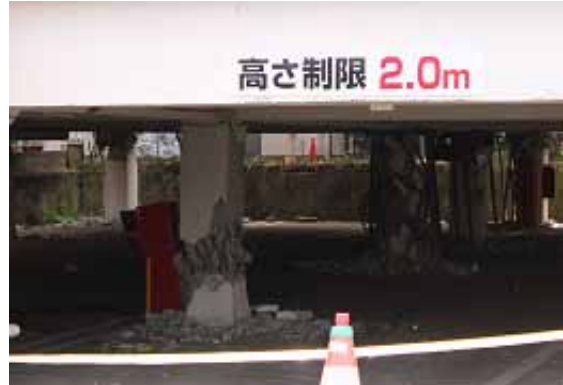
仙台市内で見かけた RC 柱のせん断破壊
