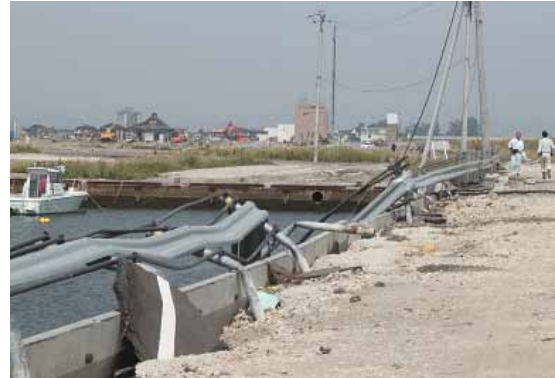
プレキャストL型擁壁と折れ曲がったガードレール。
