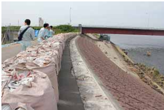
パラペットが無くなった状態の堤防護岸
