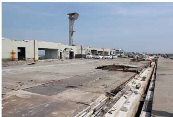
関上魚市場は、一部の壁を残して屋根も壁も消えてしまった
