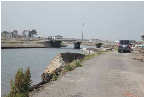
関上地区の中を流れる河川護岸の被災状態
