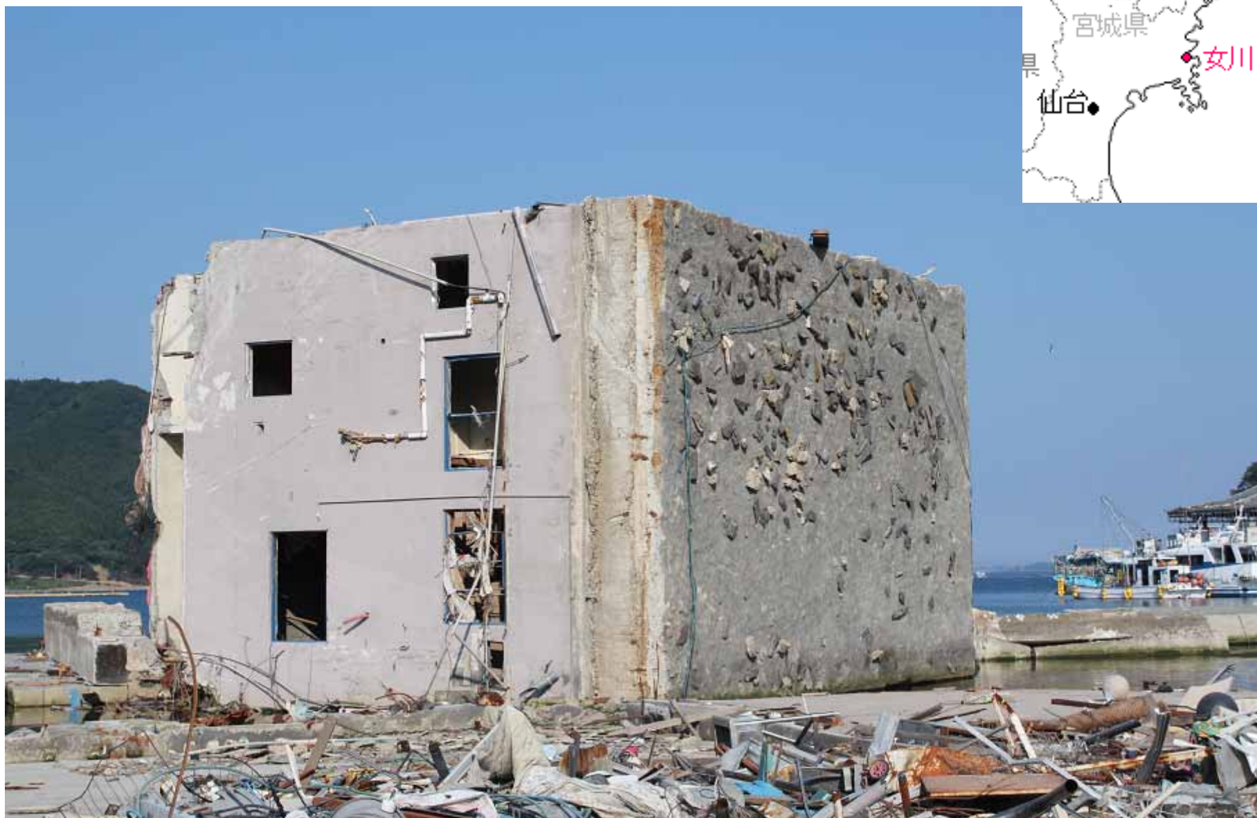
転倒したRC造のビル
