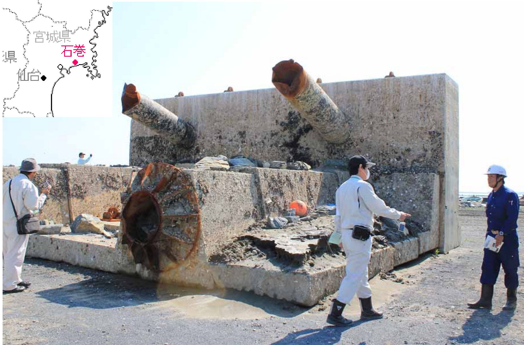
津波で破壊された離岸堤が、引上げられていた
